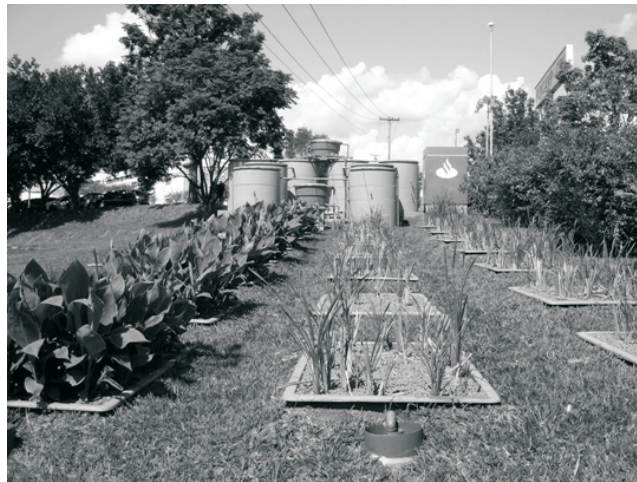
ETE utilizando reatores e leitos cultivados
