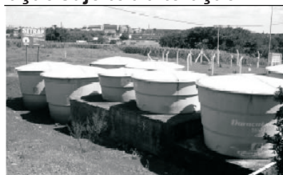
Estação de Tratamento de Esgoto
